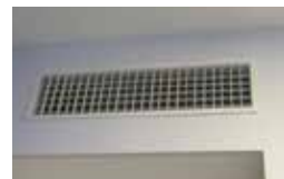
エアコン吹き出し口
